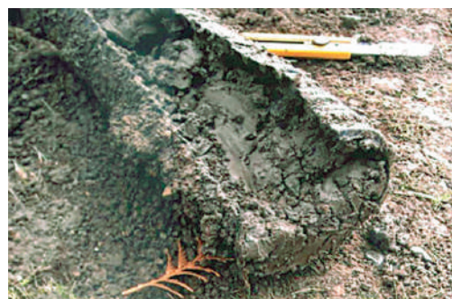
Figure 14 Drain colmaté et sol de fondation saturé propice au gonflement (Source Socabat)
